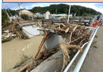
天竜区嘯月橋損壊
